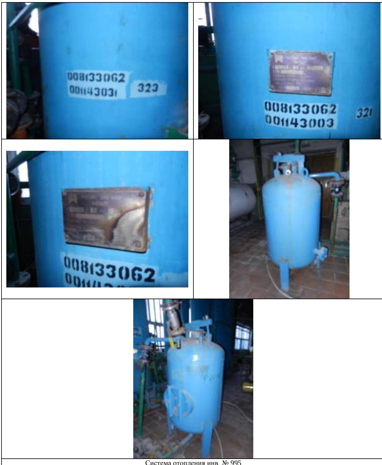
Система отопления инв. № 995
